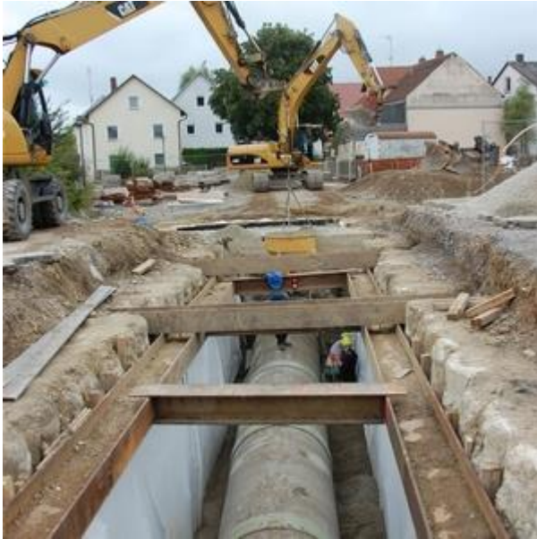
Die Rohrleitung zwischen Pumpwerk und Überlaufbauwerk mit einem Durchmesser von 1,60 Meter
